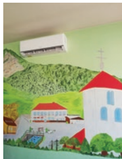
V spoločenskej miestnosti boli nainštalované dve klimatizačné jednotky
