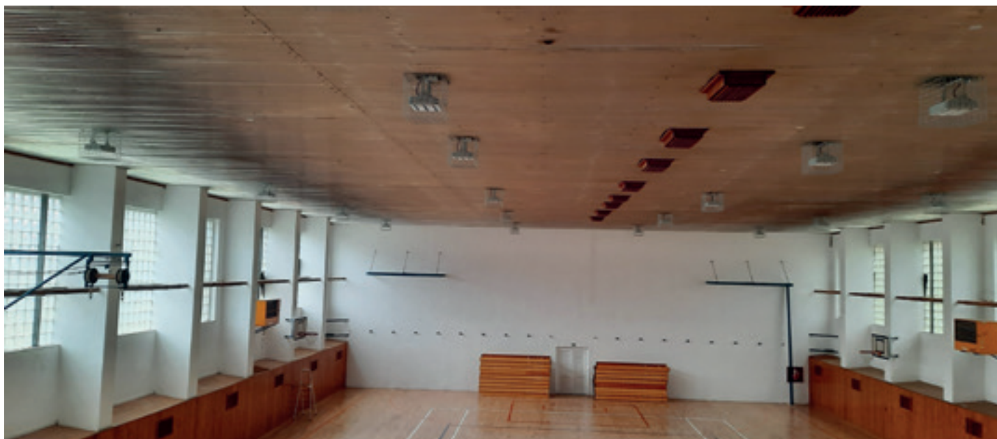
Modernizovaná elektroinštalácia v športovej hale
